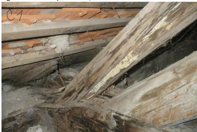
Degradovaná část pozednice, vazného trámu a krokve
